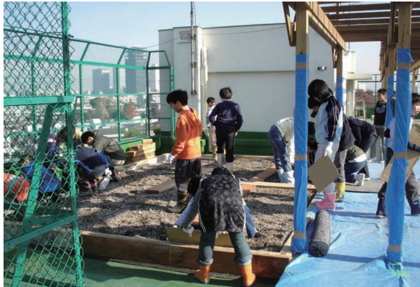
屋上緑化 (杉並区立杉並第三小学校)
